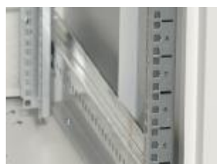
Цифровая маркировка на монтажных стойках
